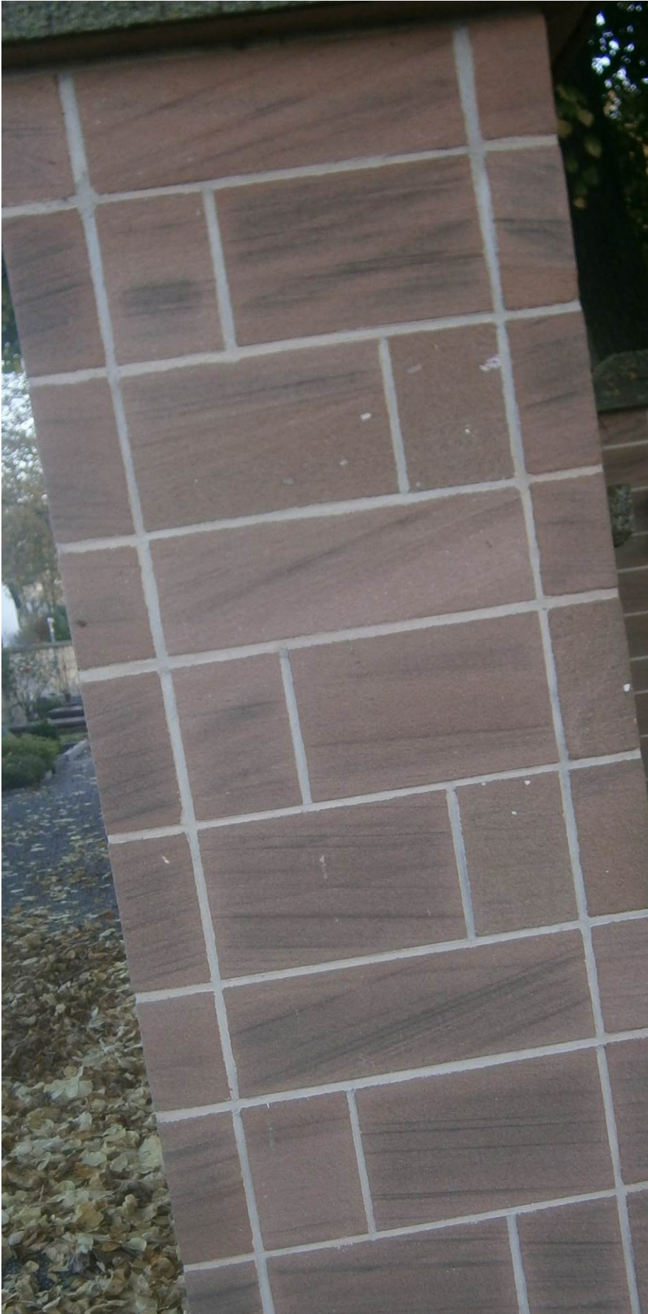
Bild schiefe Mauer
